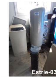
Estrie-038 Système de traitement par adoucisseur installé sur un puits domestique
